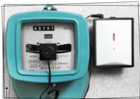
Le service Qinergy analyse et détaille votre consommation électrique depuis le compteur de la maison
